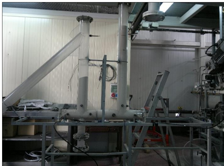
Figura 4.27. Instalación del punto de aireación sobre la rama de retorno en el modelo.
