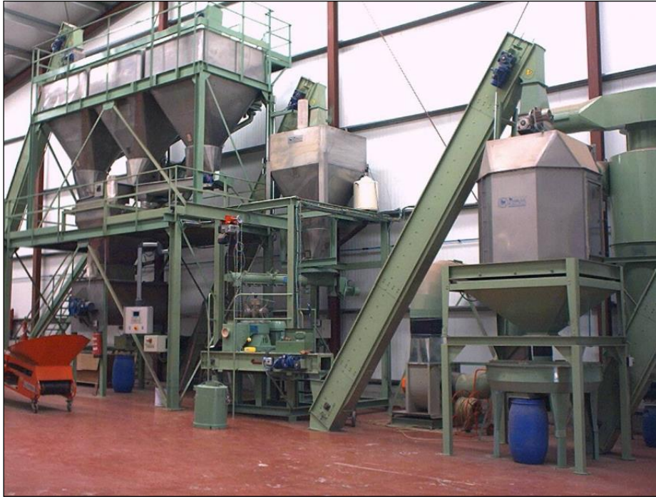
Figura 2.6. Vista general de la planta piloto de densificación.
