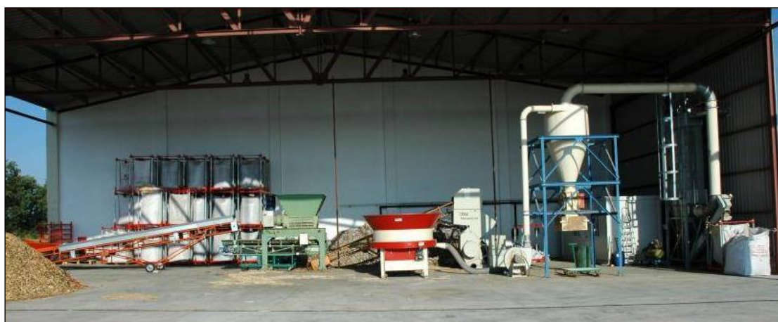
Figura 2.5. Vista general de los equipos de trituración.
