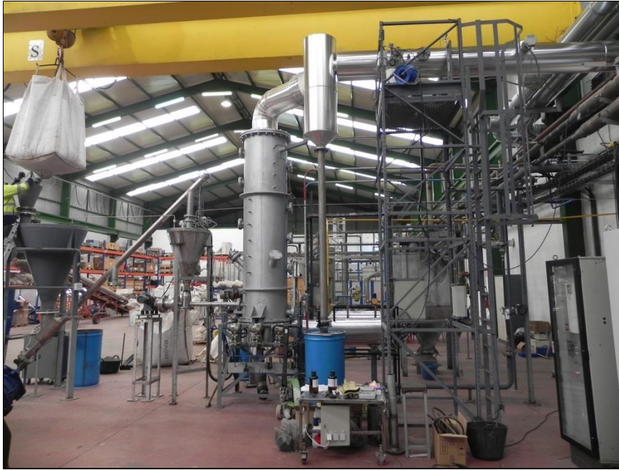
Figura 2.11. Vista general de la planta piloto de gasificación de lecho fluidizado burbujeante.
