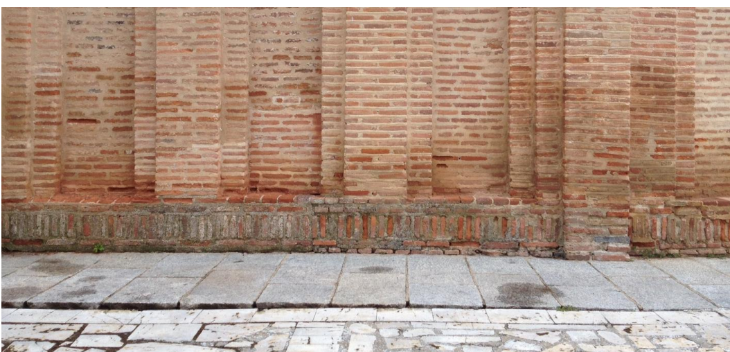
Imágenes 64 y 65. Fábricas similares a las estudiadas. Ejecutadas con ladrillo antiguo de tejar macizo y con juntas gruesas de argamasa de cal. Se aprecia el deterioro producido por la ascensión de agua por capilaridad
