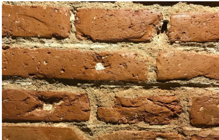
Imagen 21. Detalle de exfoliación de ladrillo de tejar por presencia de caliches superficiales
