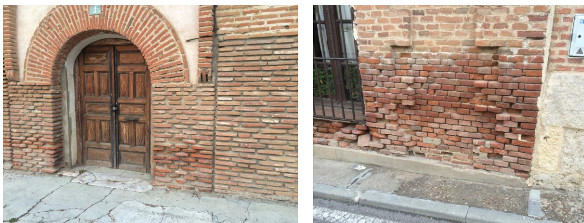
Imágenes 264, 265, 266 y 267. Edificios con presencia de humedad capilar y daños derivados de dicho fenómeno
