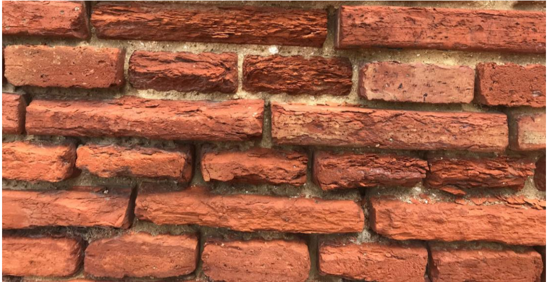
Imagen 18. Detalles de degradación de ladrillos de tejar por procesos de hielo-deshielo
