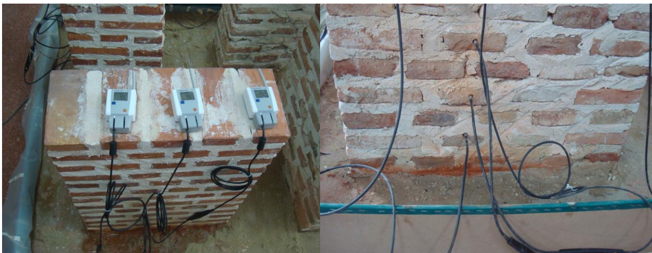
Imágenes 182 y 183. Sondas tomando datos de humedad y temperatura
