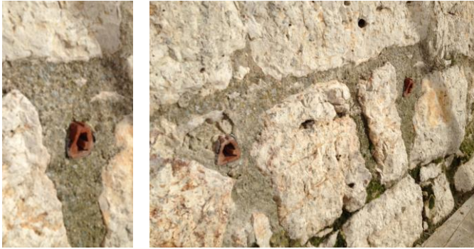
Imágenes 12 y 13. Detalle de un higroconvector colocado en un muro de mampostería. Archivo Histórico de Simancas (Valladolid)
