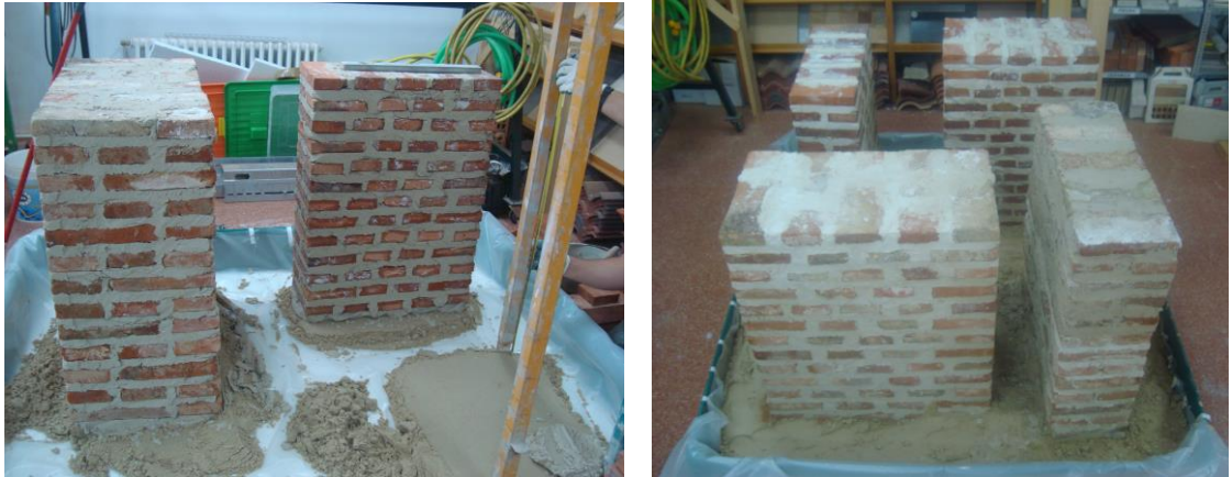
Imágenes 89 y 90. Ejecución de los cuatro muros, e imagen de ellos una vez finalizados
