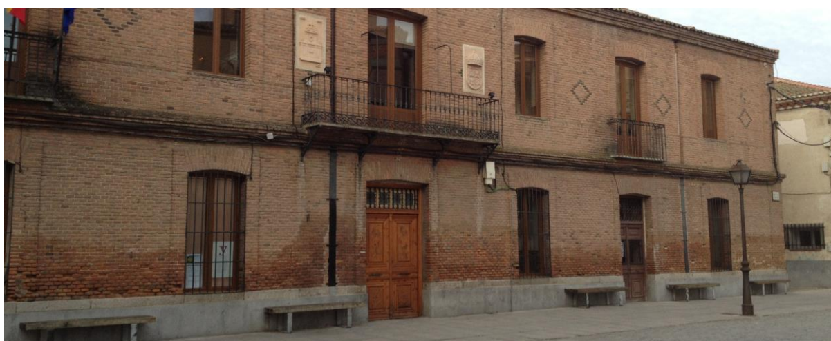
Imágenes 68,68 y 70. Fábricas de ladrillo de tejar macizo, del tipo de las estudiadas en esta tesis. Se puede apreciar claramente en todas ellas la cota alcanzada por el frente húmedo y las lesiones derivadas de la presencia de la humedad, agravadas por soluciones constructivas incorrectas.
