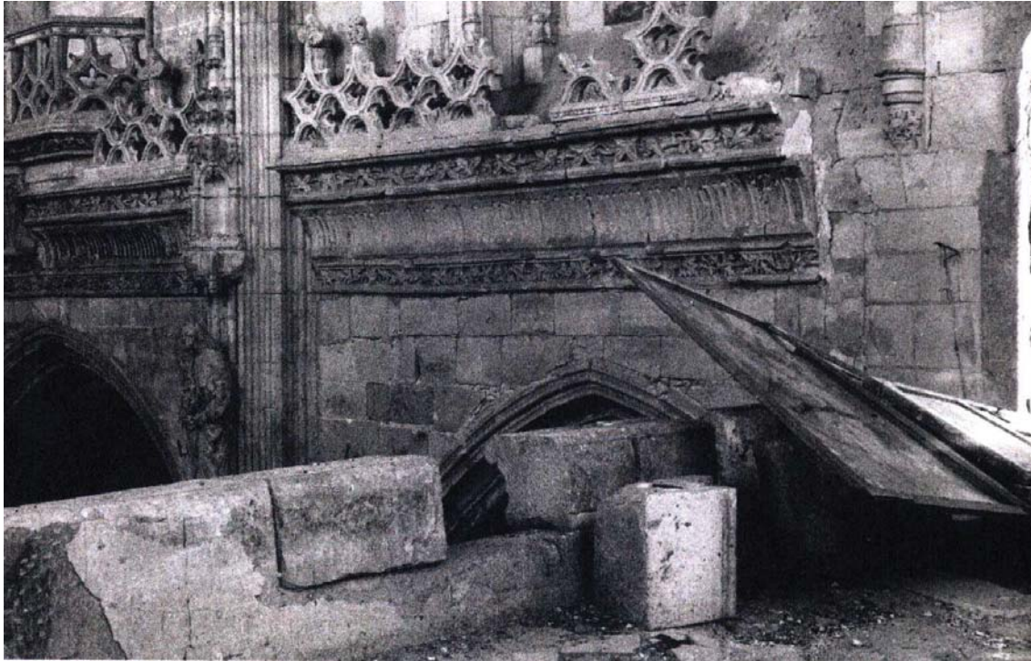
Fig. 29. Daños provocados por un rayo en el coro alto.
