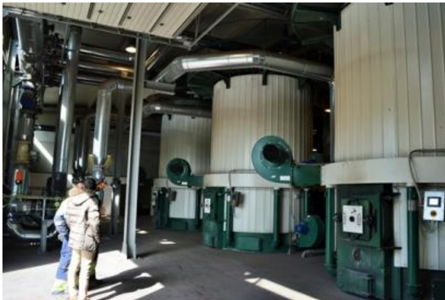
Figura 20: calderas de biomasa e la red de calor de la Uva [30]
