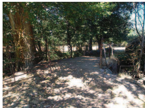
Foto 10: Vista general del puente y estado de las barandillas.
