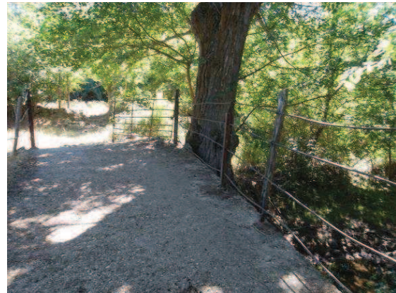
Foto 8: Tablero de hormigón-estado de las barandillas
