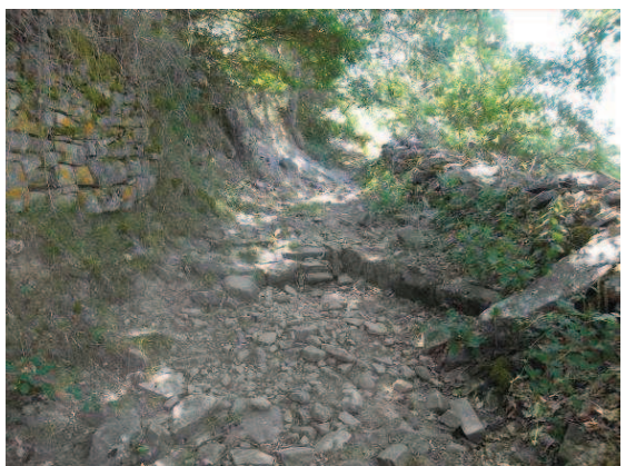
Foto 16: Estado del camino existente que acusa el discurrir de las aguas de lluvia
