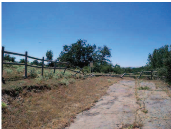
Foto112: Estado del cerramiento
