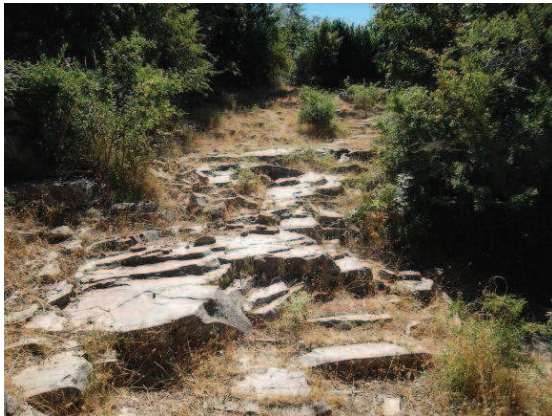
Foto 19: Estado del firme del camino
