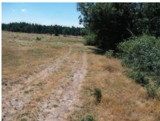
Foto 71: Estado del camino actual
