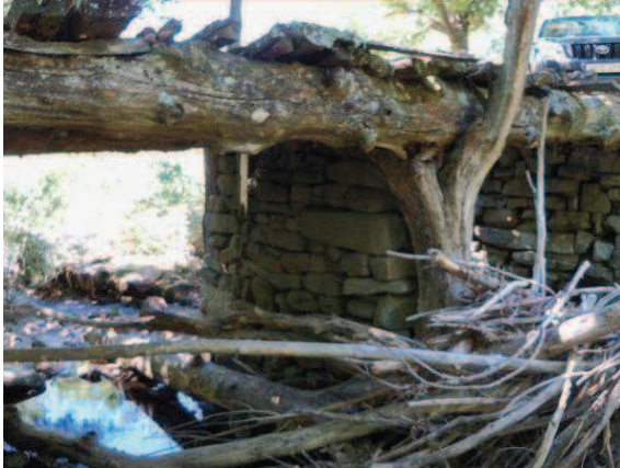
Foto 122: Acarreos que obstruyen la sección en el apoyo central
