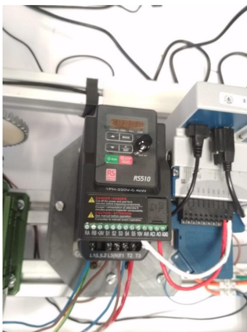
Figura 28. Variador instalado en el banco de pruebas.
