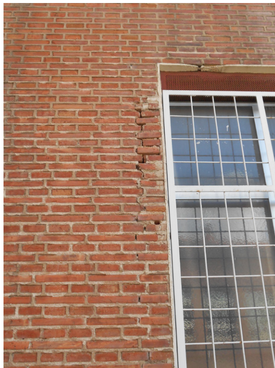
Figura 4.2.25. Grieta en junto a ventana por cambio de carpintería.
