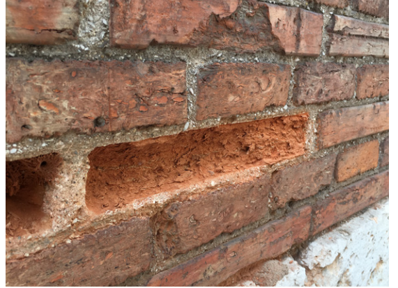
Figura 4.6.9. Erosión del ladrillo en las capas superiores.
