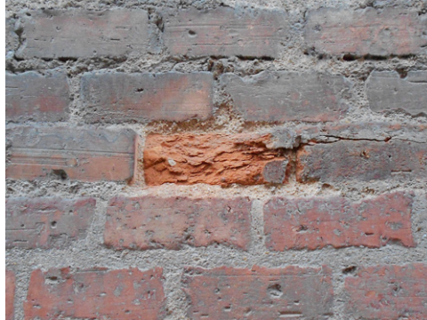
Figura 4.4a.14. Ladrillo erosionado por heladicidad.
