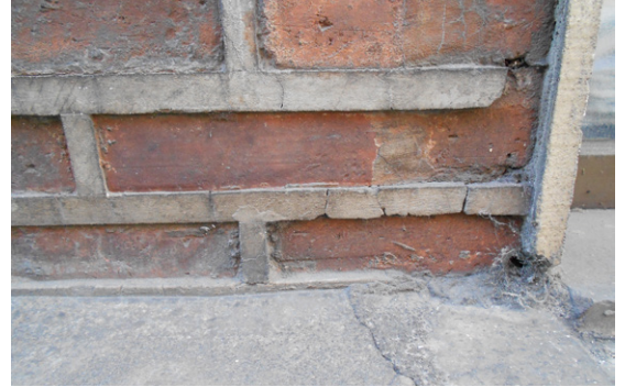
Figura 4.2.15. Rotura de la capa exterior del ladrillo.
