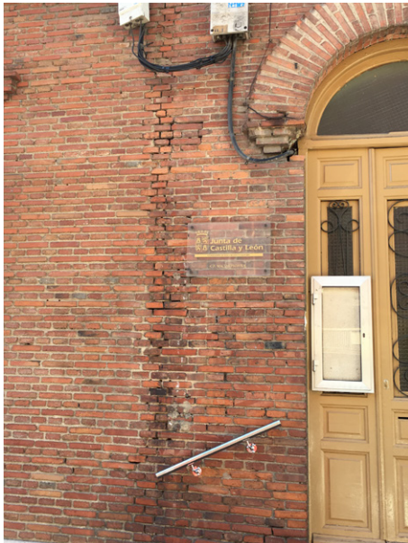
Figura 4.5.4. Lesión por lavado del agua en una bajante que existía anteriormente.
