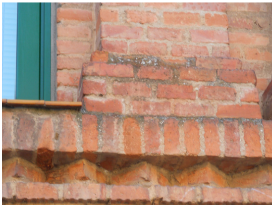
Figura 4.4b.6. Parte baja de pilastra. Fachada Noreste.
