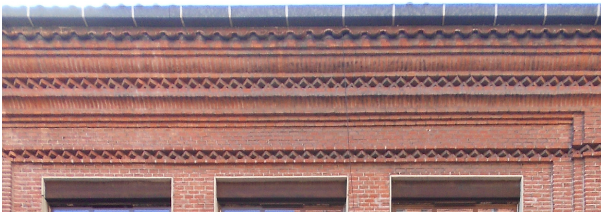
Figura 4.2.20. Suciedad en zona alta de la fachada.
