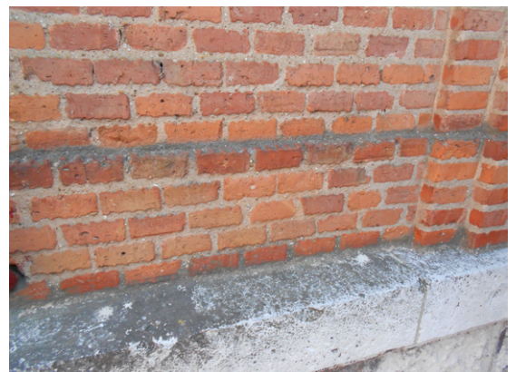
Figura 4.4a.17. Suciedad acumulada por depósito.
