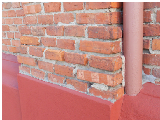
Figura 4.1.13. Perdida de mortero en el inferior de una pilastras. Fachada Oeste.
