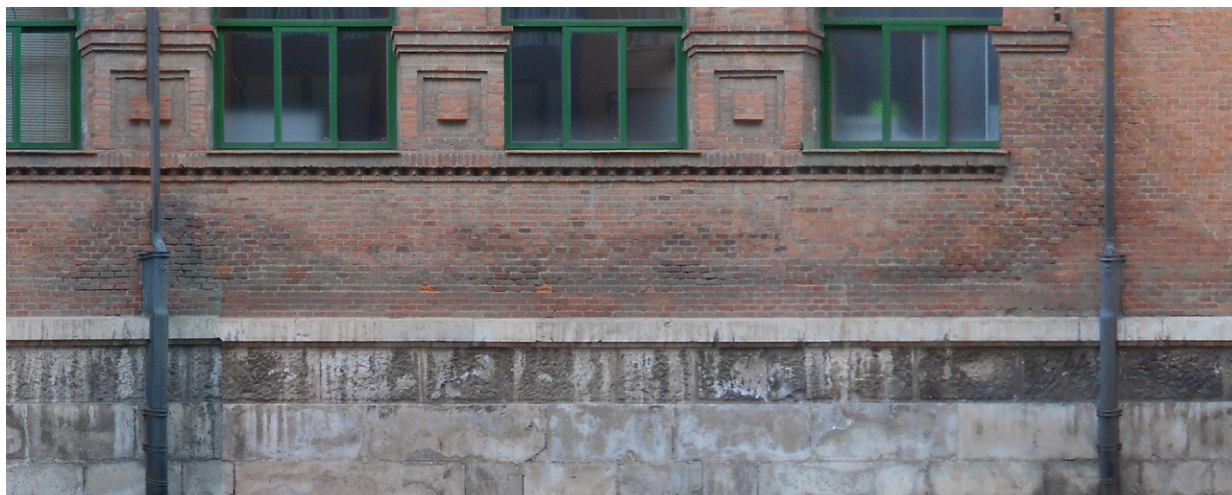
Figura 4.4a.13. Mancha de humedad por rotura de una canalización.
