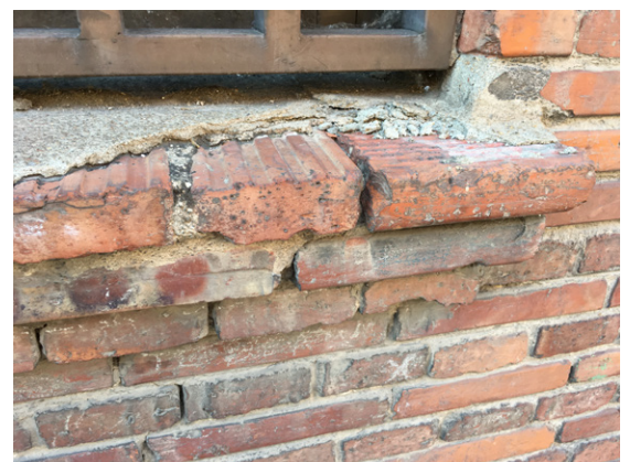
Figura 4.5.7. Vierteaguas en mal estado.
