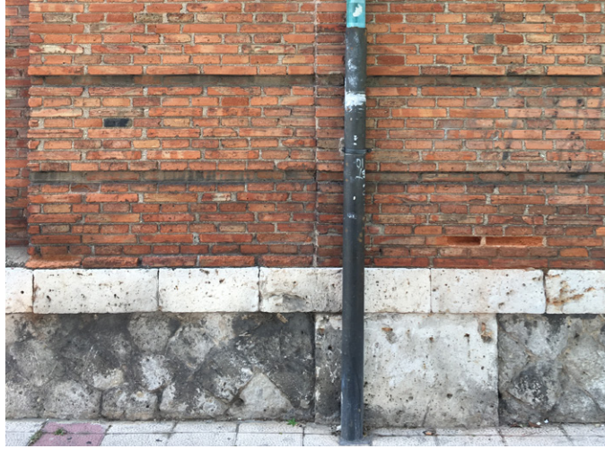
Figura 4.6.7. Humedad capilar y ladrillos erosionados en la base.
