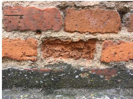
Figura 4.4b.10. Ladrillo erosionado por heladicidad.
