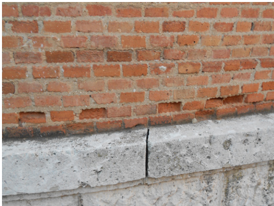
Figura 4.4b.9. Erosiones en ladrillos de la zona baja.
