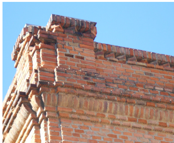
Figura 4.4b.12. Suciedad en cornisa.
