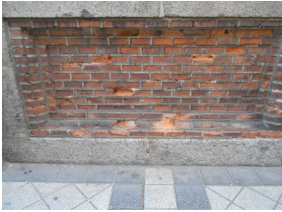
Figura 4.2.18. Panel con varios ladrillos erosionados.
