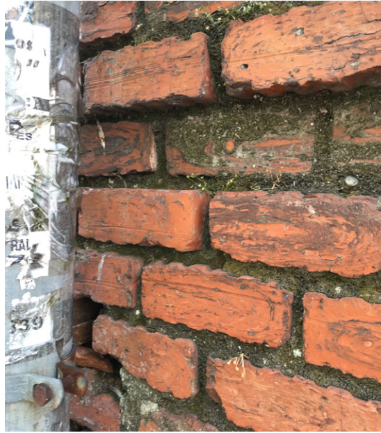
Figura 4.6.10. Capa de musgo bajo el desagüe de una limahoya.
