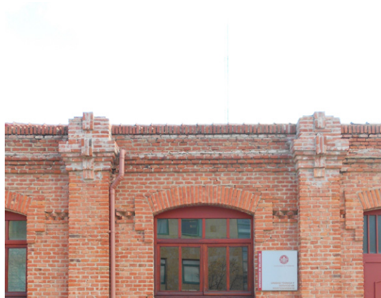
Figura 4.1.10. Eflorescencias en la cornisa. Fachada Oeste.
