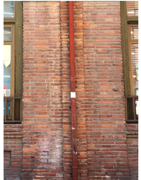
Figura 4.5.5. Lesión por lavado del agua en una bajante.
