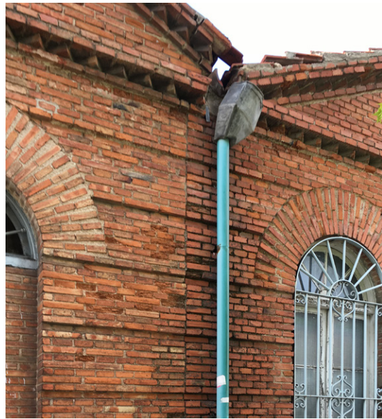
Figura 4.6.5. Humedades vertido de una limahoya.
