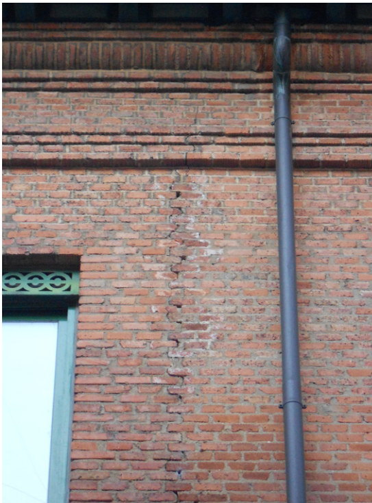
Figura 4.4a.19. Grieta vertical por dilatación y humedades.
