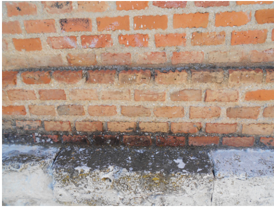
Figura 4.4b.13. Suciedad por depósito y humedad.
