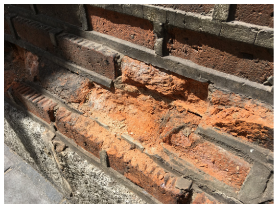
Figura 4.2.17. Arenización de varios ladrillos en la zona baja.
