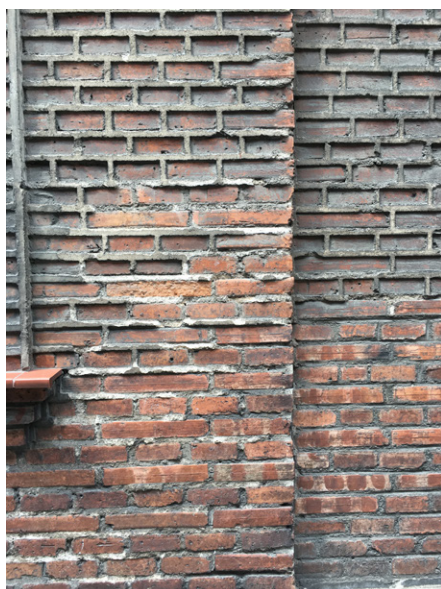
Figura 4.3.10. Ladrillos con pérdidas de material.
