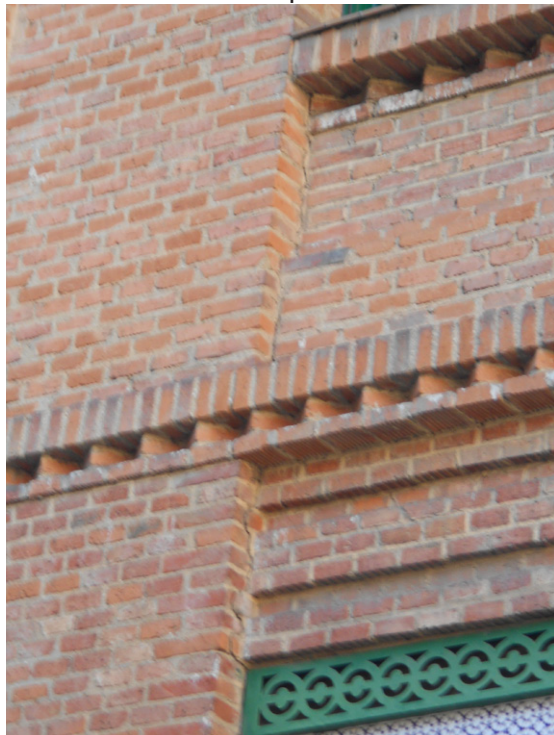
Figura 4.4a.18. Grieta bajo ventana.
