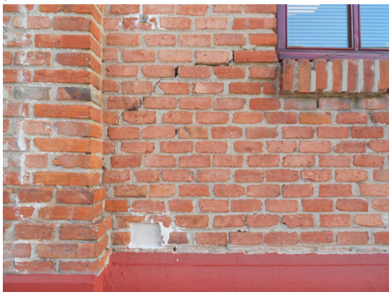
Figura 4.1.23. Grieta con dirección diagonal. Fachada Oeste.
