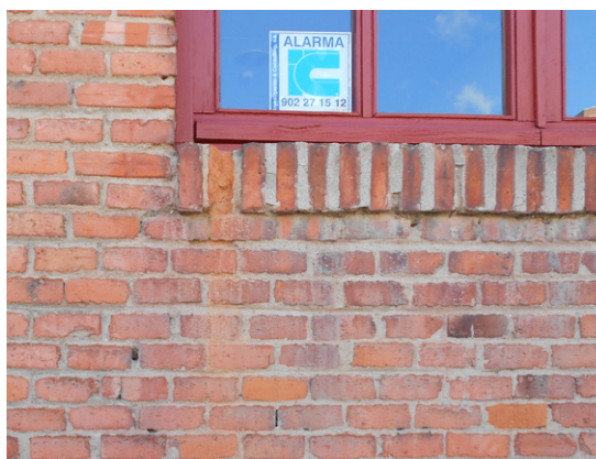
Figura 4.1.15. Meteorización en una albardilla. Fachada Norte. Fotografía propia.
