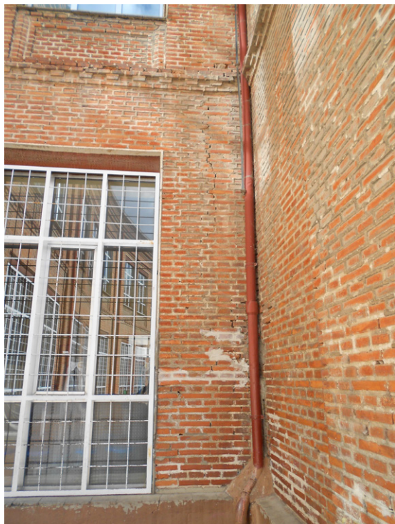
Figura 4.2.24. Grieta en la zona interior del patio.
