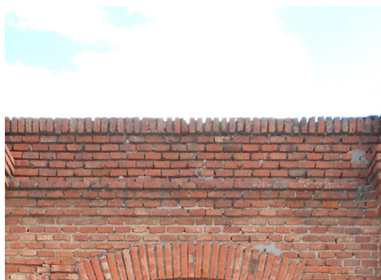
Figura 4.1.11. Perdida de juntas en la cornisa. Fachada Oeste.
