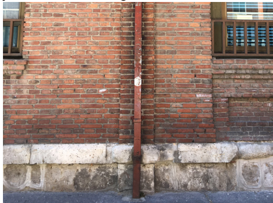
Figura 4.5.8. Humedad capilar en la zona baja.
