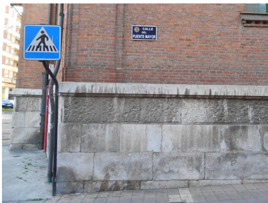
Figura 4.4a.16. Suciedad en zócalo.
