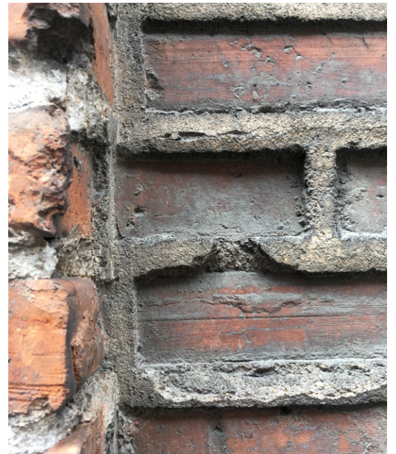
Figura 4.2.23. Detalle de la erosión de las juntas.
