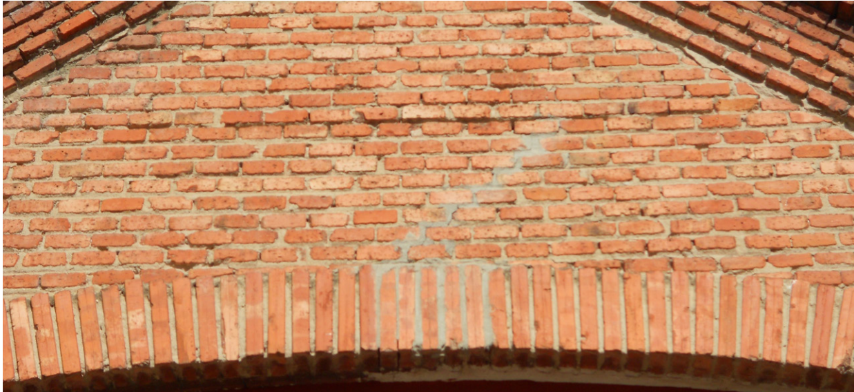
Figura 4.1.26. Grieta en arco rebajado. Fachada Sur.
