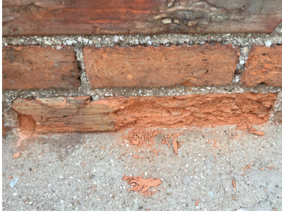
Figura 4.6.8. Ladrillo erosionado por heladicidad.
