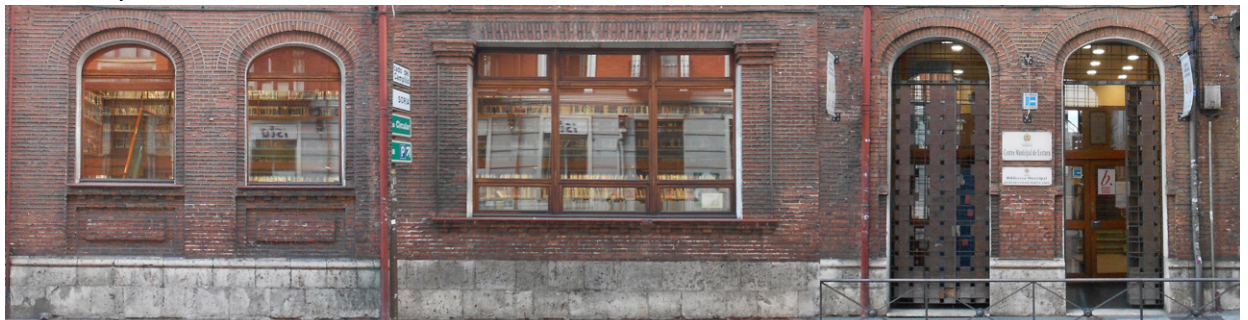
Figura 4.3.13. Suciedad de la zona inferior.
