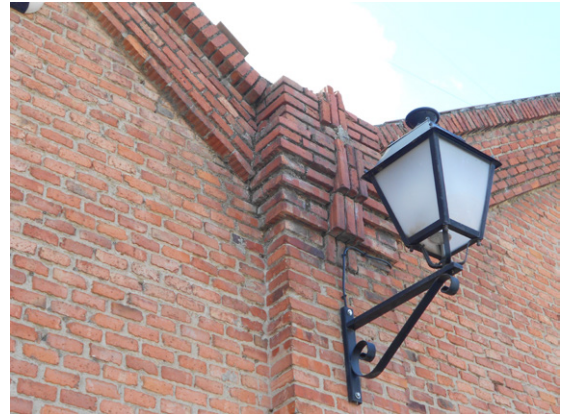
Figura 4.1.21. Suciedad en el inferior de una pilastra. Fachada Norte.
