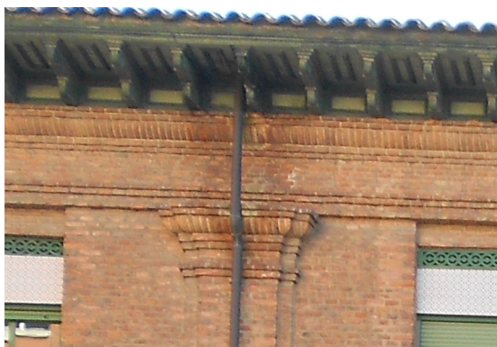
Figura 4.4a.8. Humedad en coronación por fuga del canalón.
