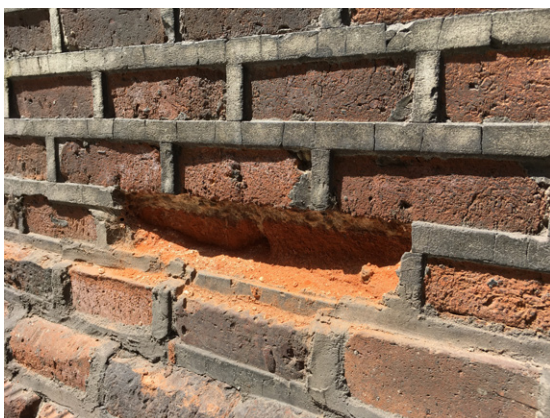
Figura 4.2.16. Arenización del ladrillo en la parte baja.
