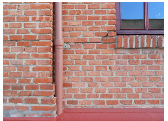
Figura 4.1.24. Grieta con dirección horizontal. Fachada Oeste.
