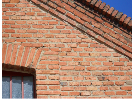
Figura 4.1.25. Grieta con dirección diagonal. Fachada Sur.
