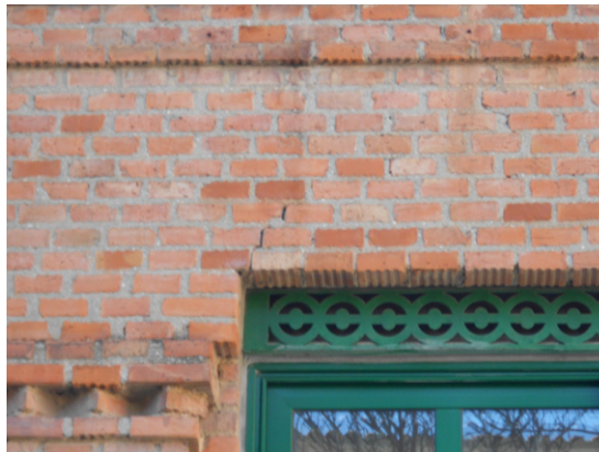
Figura 4.4b.15 . Grieta en dintel.
