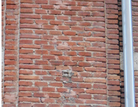
Figura 4.2.21. Deterioro como consecuencia de la suciedad en zona media.
