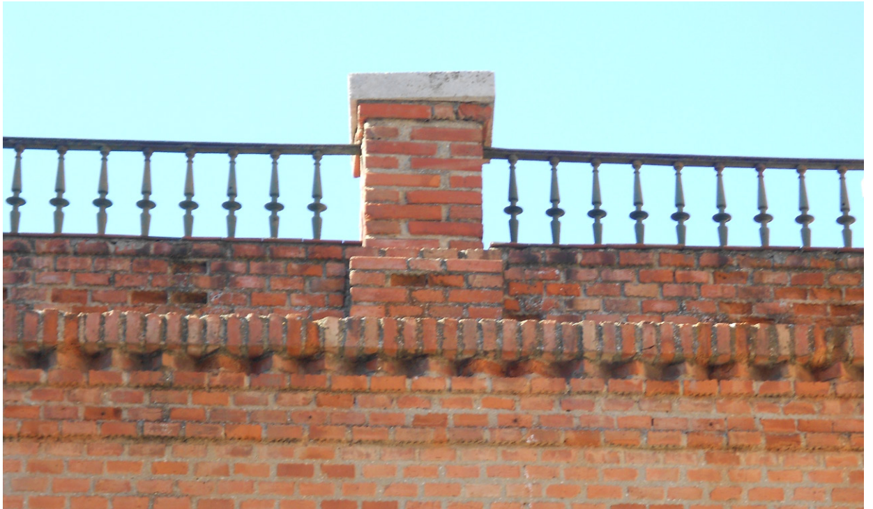
Figura 4.4b.5. Lesiones en la coronación. Fachada Sureste.
