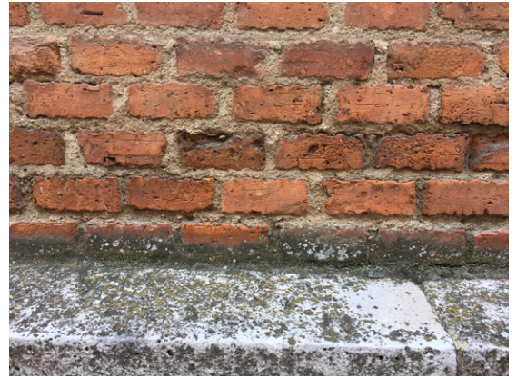
Figura 4.4b.14. Suciedad por depósito y humedad.
