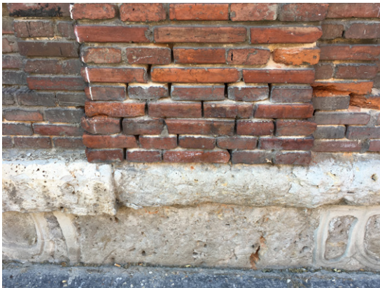
Figura 4.5.9. Pérdida de juntas en la base.
