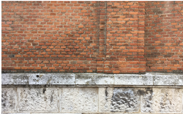
Figura 4.4b.8. Humedad capilar en la parte baja.
