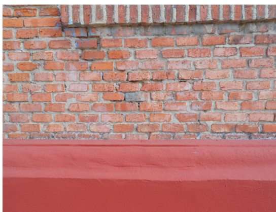
Figura 4.1.19. Erosión generada por la limpieza del grafiti.
