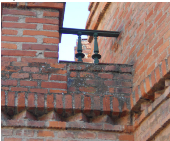
Figura 4.4b.11. Suciedad en coronación.
