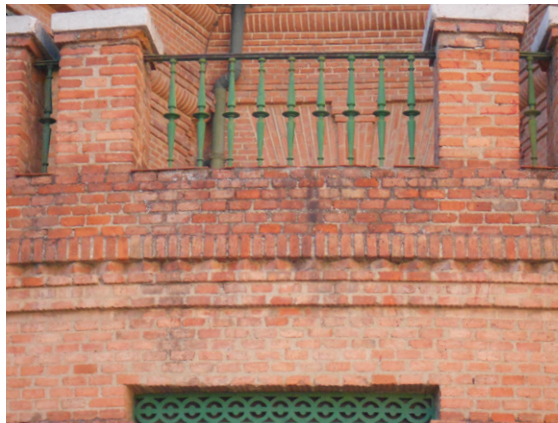
Figura 4.4a.15. Suciedad por arrastre de suciedad del vierteaguas.
