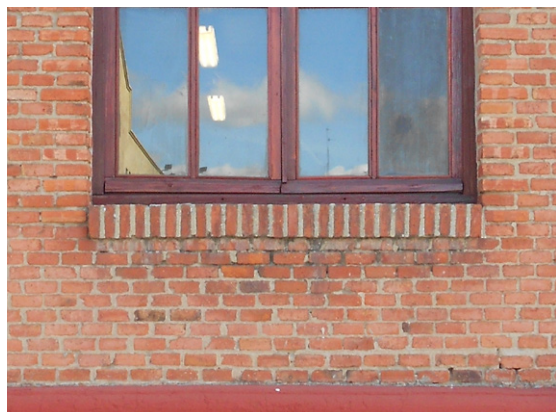
Figura 4.1.12. Lavado de juntas en el inferior de una alfeizar. Fachada Oeste.
