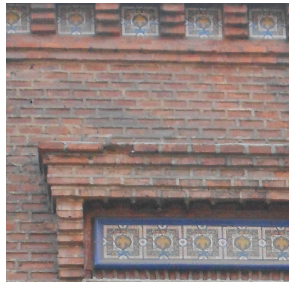
Figura 4.3.6. Desprendimiento en escupeaguas.
