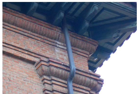
Figura 4.4a.9. Eflorescencia en coronación por fuga del canalón.
