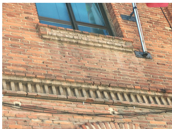
Figura 4.5.11. Suciedad por falta de lavado bajo ventana.
