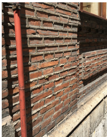
Figura 4.3.9. Erosiones en la parte baja.
