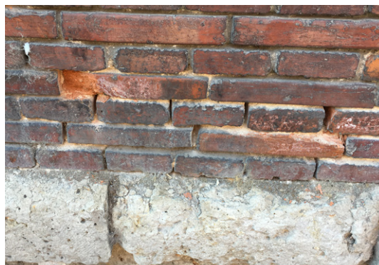
Figura 4.5.10. Ladrillos con exfoliaciones en la base.
