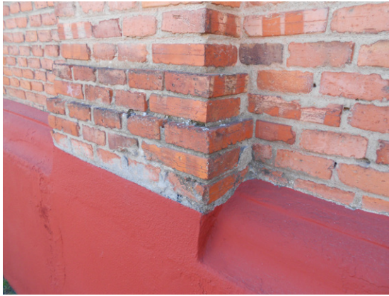
Figura 4.1.20. Suciedad en el inferior de una pilastra. Fachada Norte.
