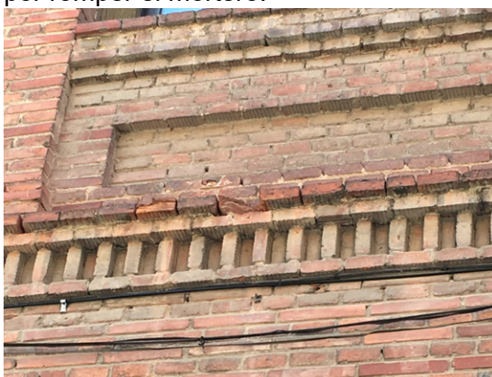
Figura 4.5.6. Pérdida de juntas en ornamentos.
