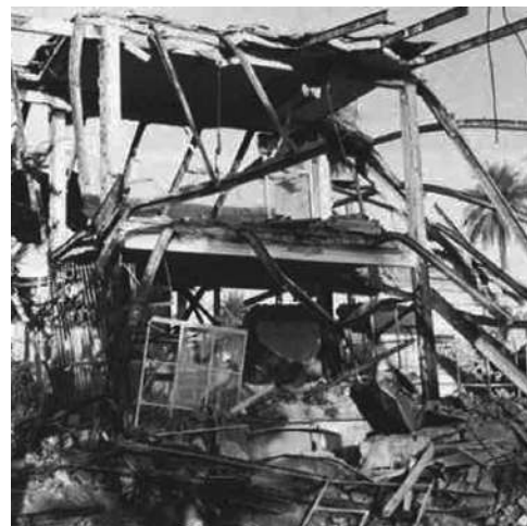
Figura 16: Imagen de los efectos del terremoto de 7.7 en la escala de Richter en Tabas (Irán) en el año 1978. Fuente: Ceramic Houses & Earth Architecture
