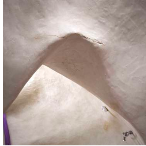
Figura 101: Detalle de fisura en la "clave" del arco. Elaboración propia.
