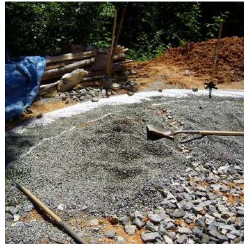
Figura 57: Colocación de la grava en el suelo. Imagen original obtenida de: https://ecoinventos.com/earthbag-aprende-a-hacer-una-casa-con-sacos-de-tierra/
