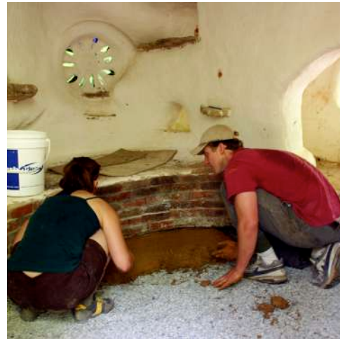
Figura 58: Ejecución de la capa aislante con barro y paja. Imagen original obtenida de: https://heartwoodhomesteads.files.wordpress.com/2009/12/img_1069.jpg
