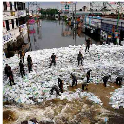
Figura 21: Dique de contención frente a una inundación. Imagen original obtenida de: https://ep01.epimg.net/diario/imagenes/2007/11/03/internacional/1194044403_740215_0000000000_noticia_normal.jpg
