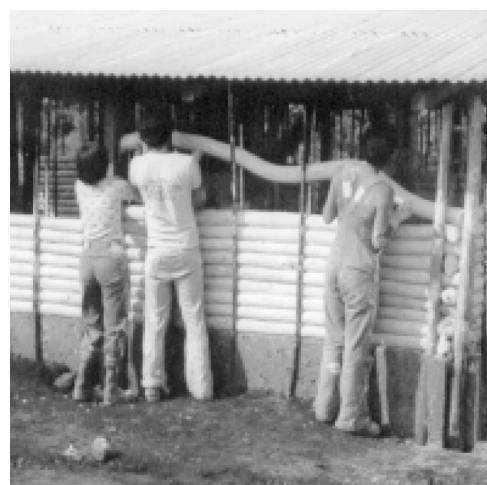
Figura 24: Colocación de las mangueras rellenas de tierra de la vivienda antisísmica en Guatemala, 1978. Fuente: Ceramic Houses & Earth Architecture
