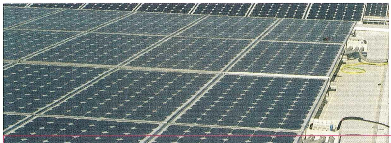
En las instalaciones sobre tejado se alcanza temperaturas superiores a 90 °C con frecuencia. El cable Tecsun está diseñado para soportar estas temperaturas
