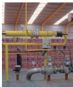
Canalización del biogás
