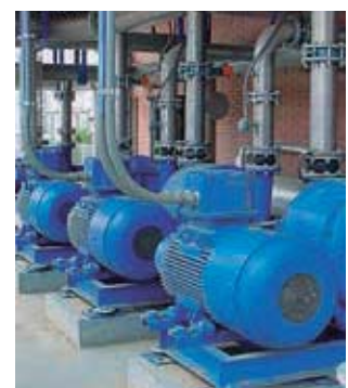
Estación de tratamiento del biogás
