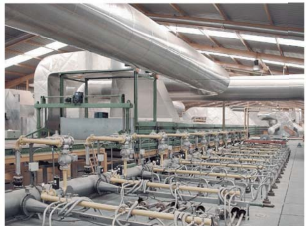
Quemadores de biogás en la planta de fabricación de ladrillos cerámicos Piera
