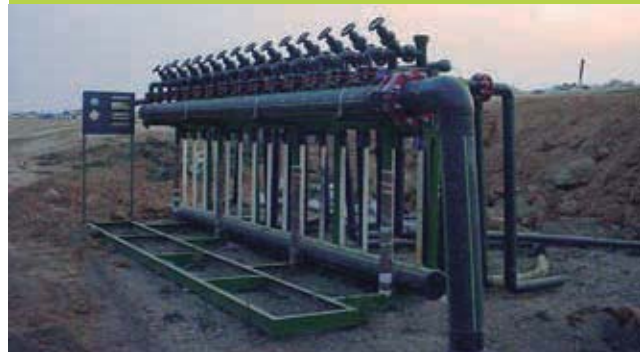
Estación de regulación de biogás en el vertedero de Can Mata
