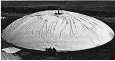
Figura 282. Proceso de ejecución de cúpula hinchable como encofrado, del arquitecto Dante Bini.
