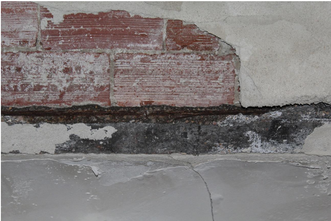
Ilustración 44. Vigüeta con suela desprendida. Fuente. Foto del autor.
