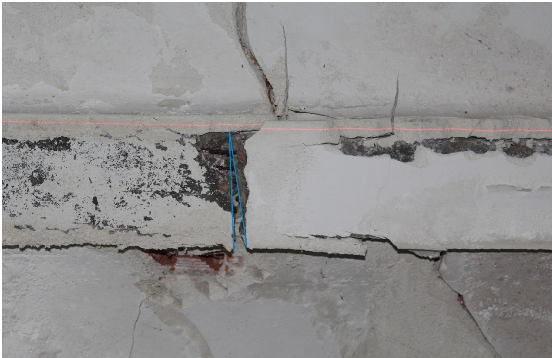
Ilustración 45. Vigüeta agrietada formando un ángulo agudo. Planta baja. Fuente: foto del autor.
