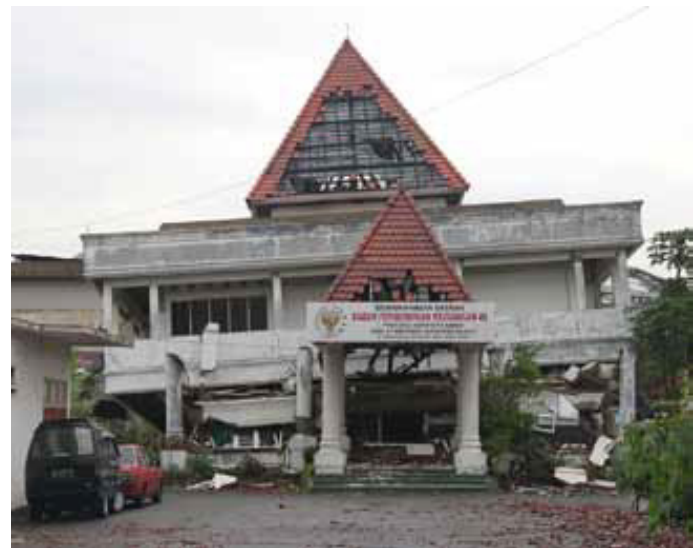
Figura 53. DAÑOS DEL TERREMOTO EN PADANG FUENTE: David Hodgkin, Fotógrafo.
