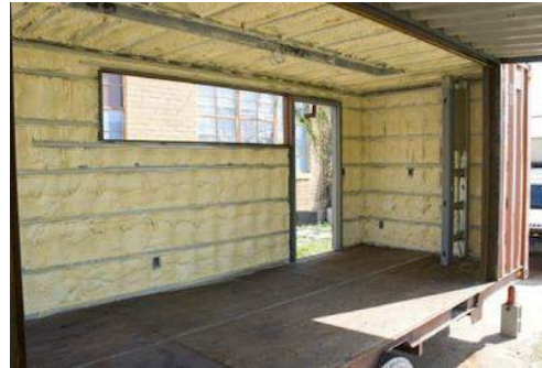
Aislamiento térmico en una vivienda container
