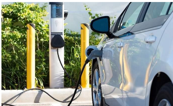
Figura 48. Fotografía de puesto de carga de vehículo eléctrico. Fuente: Google imágenes.
