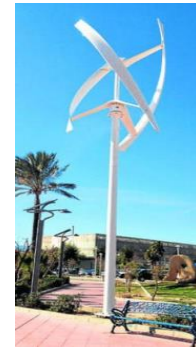
Figura 96. Fotografía de aerogenerador urbano. Fuente: Google imágenes.
