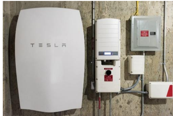
Figura 112. Fotografía de una instalación de un sistema de acumulación a base de una batería "Powerball" de TESLA. Fuente: Google imágenes.
