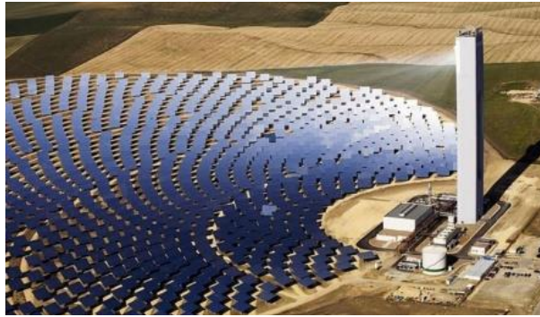
Figura 26. Fotografía de central termosolar. Fuente: Google imágenes.
