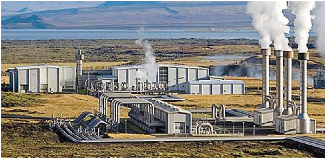
Figura 30. Fotografía de central geotérmica. Fuente Google imágenes.
