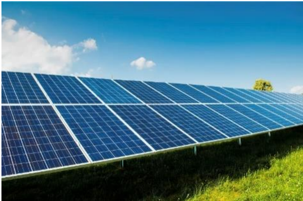
Figura 25. Fotografía de instalación fotovoltaica. Fuente: Google imágenes.
