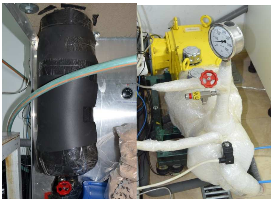
Fig. 14 y 15. Camisas de refrigeración de separador y bomba.
