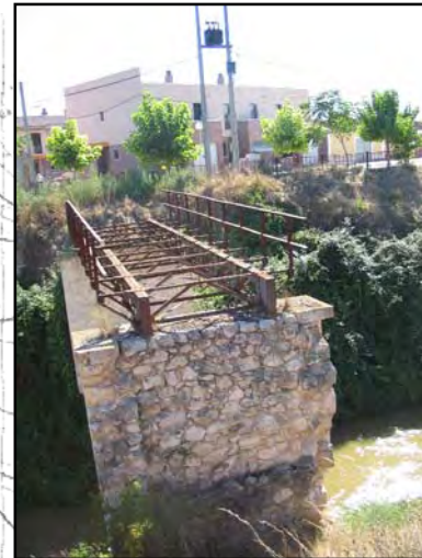
Foto 37: Puente en ruinas
