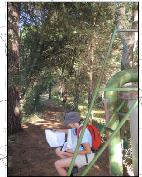
Foto 35: Tubería que cruza sobre el Canal, en P.K. 7+126
