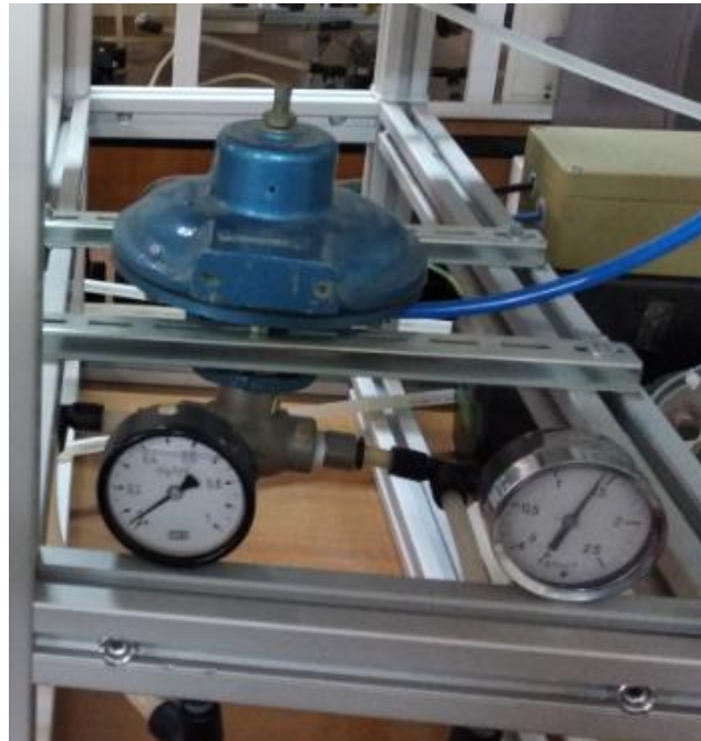
Figura 37 Válvula de control del caudal de agua (F), nuestra variable controladora.
