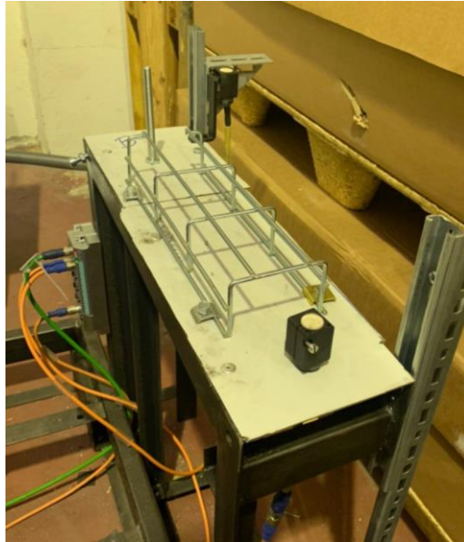
Ilustración 31: Puesto de Salida y ET200 ECO.
