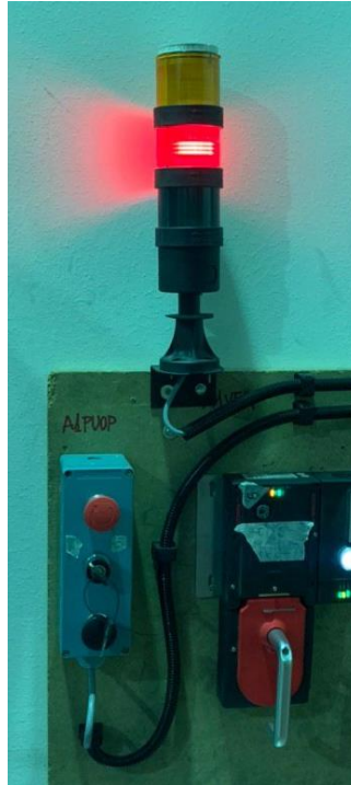
Ilustración 69: Baliza Operario Indiciando Prohibición de trabajo.
