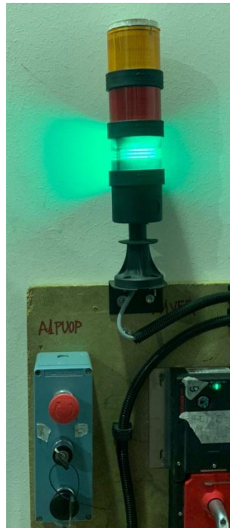
Ilustración 68: Baliza indicadora de la autorización de trabajo.
