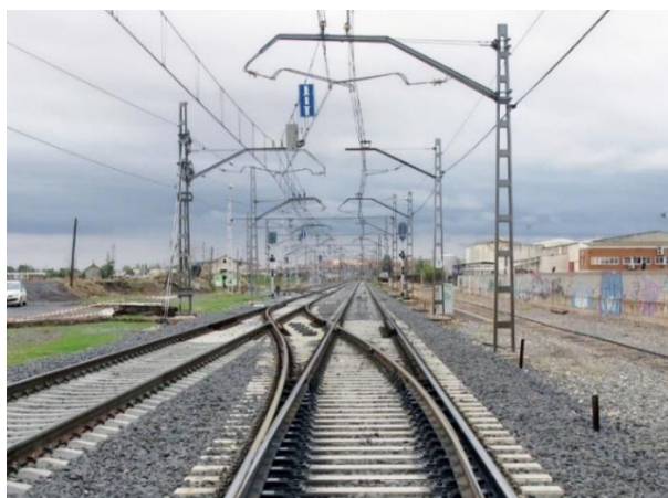
Figura 18. Tendido de catenarias sobre las vías del tren [15]
