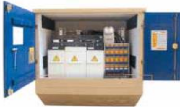
Figura 12: Interior del Centro de transformación
