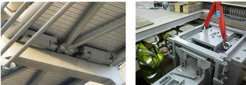
Ilustración 3. Instalación de TMDs en la pasarela Millenium. [3]
