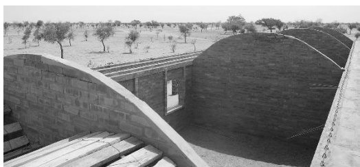
FIGURA 200: CONSTRUCCIÓN DE LOS CERRAMIENTOS Y APOYO DE LAS BOVEDAS DE LA ESCUELA
