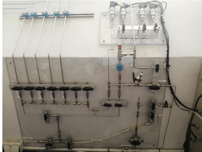
Figura 17. Sistema de conductos, válvulas y sensores de presión de suministro de aire y combustible
