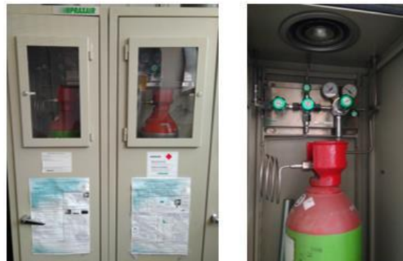
Figura 16. Combustible en botellas de alta presión
