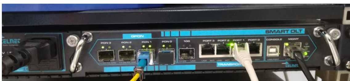
Figura 20: Imagen frontal real del OLT y los puertos PON asociados
