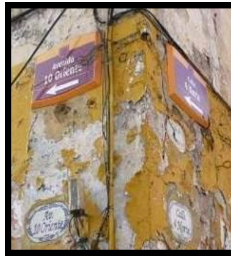
Fig. 135 Nomenclatura actual y antigua sobre edificio deteriorado 10 Ote y 4 Nte. (Fuente: FOMIX Folio MN001-2007-C01-63353)
