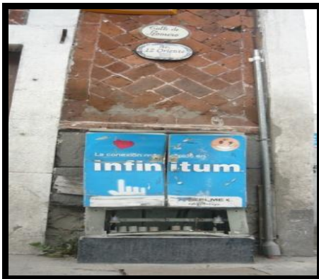
Fig. 178 Cajas de registros de telefonía (Fuente: FOMIX Folio MN001-2007-C01-63353)
