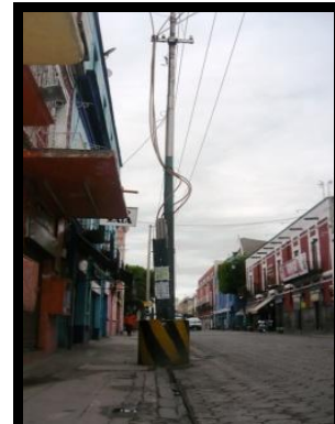
Fig. 177 Postes para las líneas de conducción de energía eléctrica (Fuente: FOMIX Folio MN001-2007- C01-63353)
