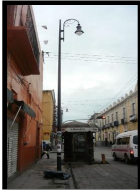
Fig. 175 Luminaria 10 oriente y 2 Norte (Fuente: FOMIX Folio MN001- 2007-C01-63353)
