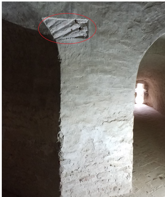
Figura 23: Punto de extracción torre SE. Nivel -2.
