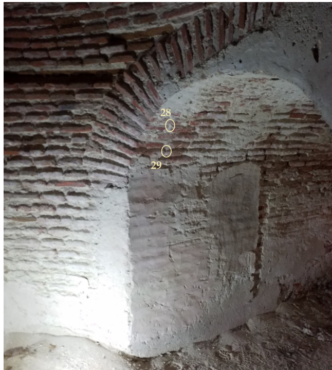
Figura 32: Puntos de extracción torre NE. Nivel -1.
