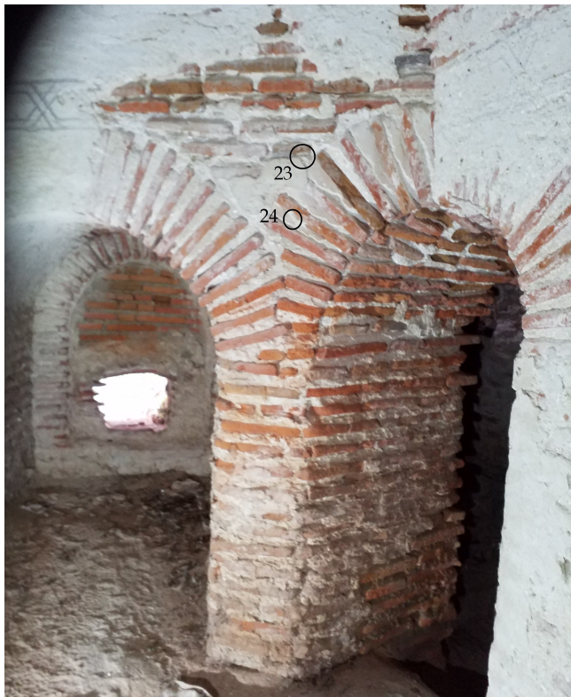
Figura 29: Puntos de extracción torre NO. Nivel -1.
