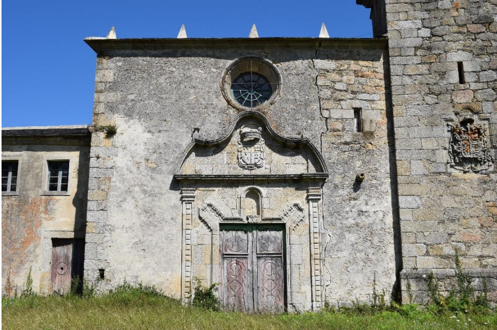
Fig. 6. Fachada de la iglesia del convento de San Martiño de Vilalourente. José Martínez Celiz. 1715-1716. Mondoñedo. Fotografía del autor
