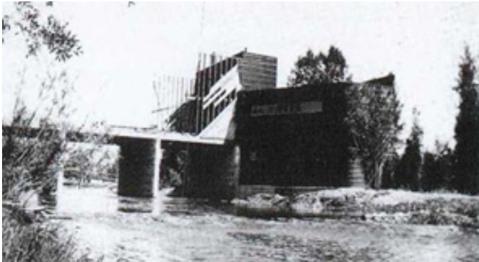
Fig 11: La White Cabin , la estructura sobre el arroyo, y el forjado de madera.
