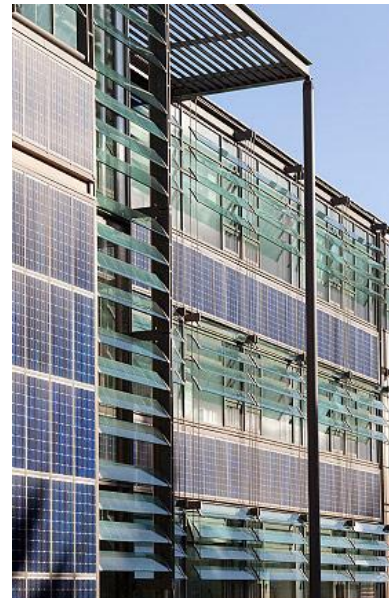
Fuente: David Hills. Fachada ventilada con placas solares fotovoltaicas
