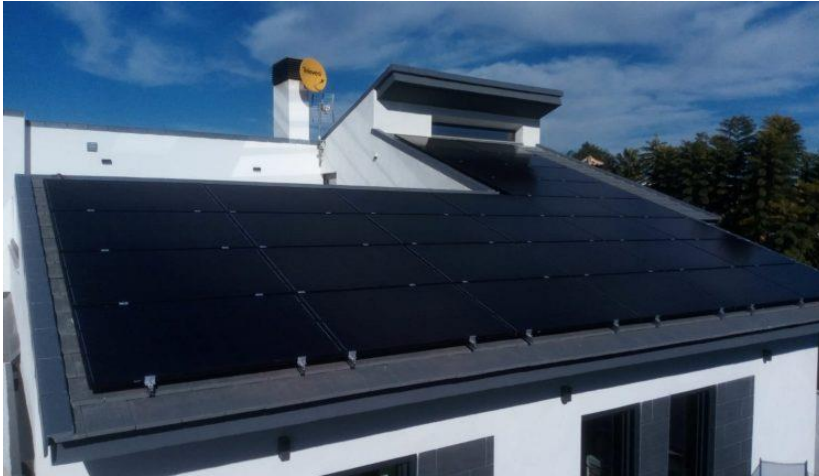
Fuente: Quantum Energía. Cubierta con placas solares fotovoltaicas integradas.
