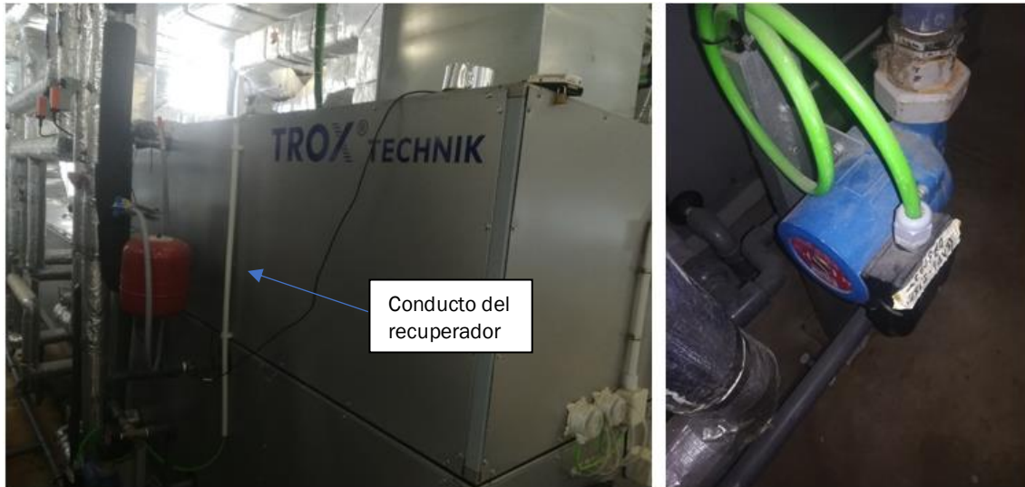
Figura 3.11.- Fotografía de la zona exterior de la UTA donde se puede apreciar la posición del recuperador y de la bomba.
