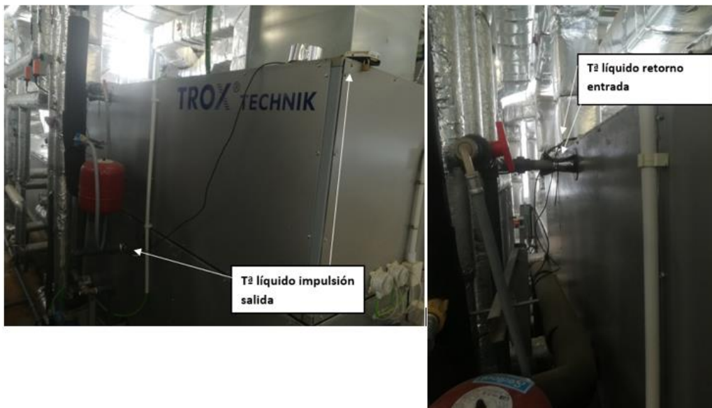
Figura 5.6.- Fotografías donde se ve la posición de los termómetros para medir la temperatura del agua del recuperador.
