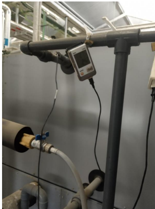
Figura 3.12.- Fotografía de la zona exterior de la UTA, donde se aprecia el conducto del recuperador junto con la sonda dispuesta en la medición de datos.
