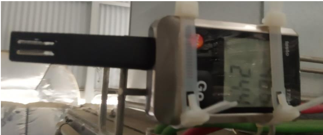
Figura 5.2.- Sondas utilizadas en el seguimiento del recuperador de calor.
