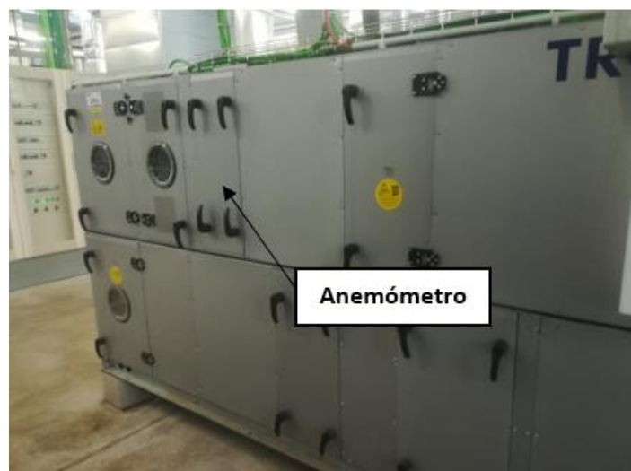
Figura 5.8.- Fotografía del climatizador con referencia a la posición del anemómetro.
