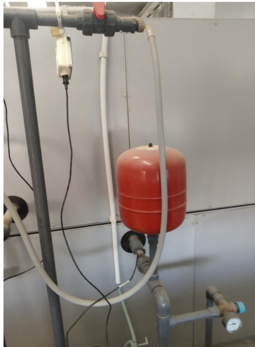
Figura 5.7.- Fotografía de la posición en el conducto de una de las sondas que registraba la temperatura del líquido del recuperador.
