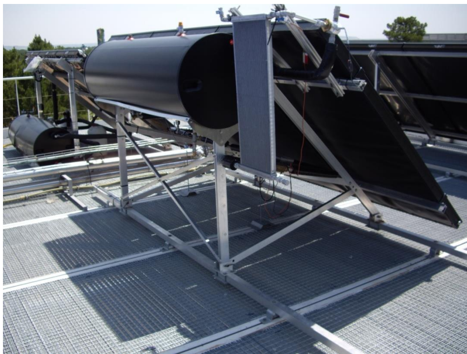
Figura 4 Sistema solar térmico forzado “AQUA V3” (Fuente: realización propia in situ)
