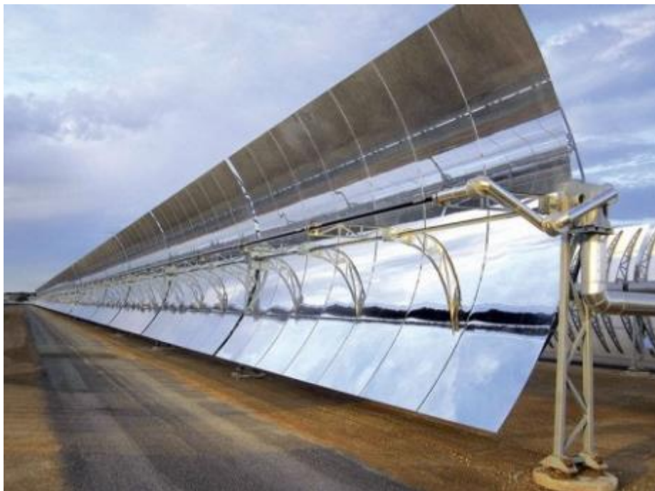
Figura 3.5 Captador de concentración (8)
