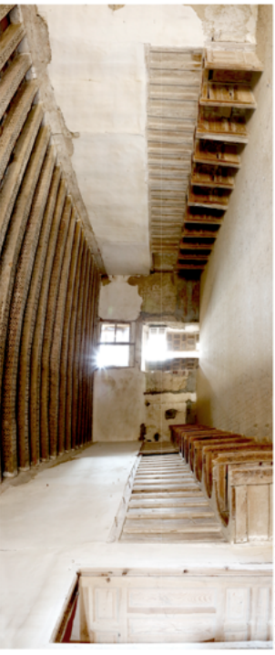
Estado actual del coro alto con parte de cubierta colapsada
