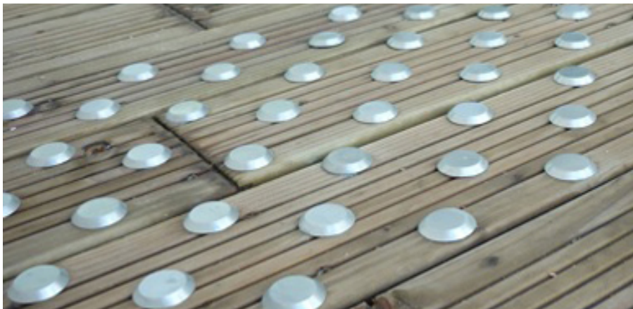
fig. 125: colocación de los botones podotáctiles
