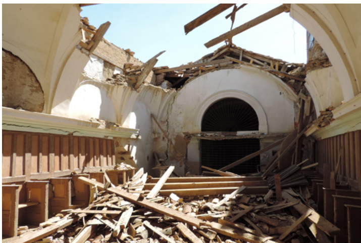
fig. 11: estado actual del alto coro.
