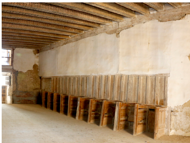
fig. 8, 9, 10: estado actual del bajo coro.
