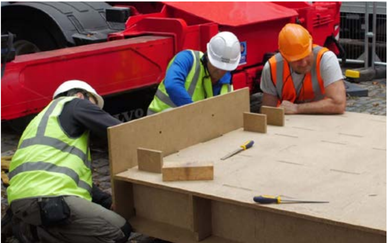
Imagen 62: Montaje de los paneles prefabricados SIP. Fuente: Recorte video "The Circular Building-A learning journey." https://www.youtube.com/watch?v=s03dNDg_hWQ&t=6s
