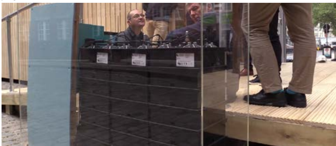
Imagen 74: Sistema de baterías AHI de Aquion Energy en "The Circular Building". Fuente: Recorte del video Recyclable house shifts construction to circular economy. https://www.youtube.com/watch?v=Tbkr200I1Dw
