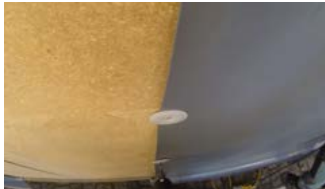
Imagen 63: Colocación lámina impermeable Fatra. Fuente: Recorte vídeo "The Circular Building-A learning journey" https://www.youtube.com/watch?v=s03dNDg_hWQ&t=6s
