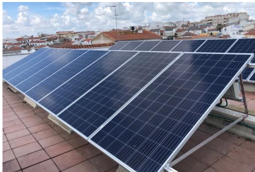
Campo fotovoltaico sobre cubierta y capo sobre estructura giratoria
