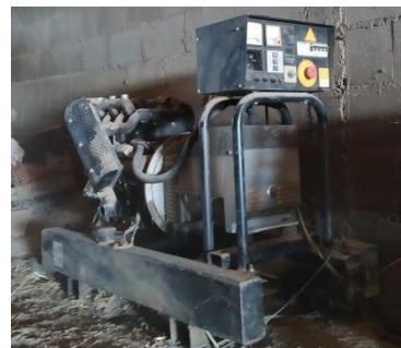
Grupo electrógeno Fuente: propia
