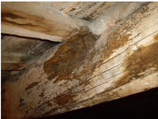
Figura 26. Pudrición parda. https://www.fumigaciobcn.cat/hongos-pudricion-la-madera/
