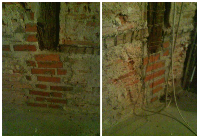
Figura 67. Apoyo de un pie derecho sobre fábrica de ladrillo. https://e-struc.com/2015/07/22/deterioro-de-pies-derechos-de-madera-en-entramados-sustituciones-correctas/
