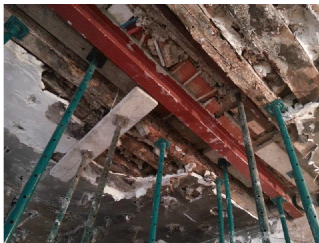
Figura 39. Apeo permanente homodireccional. https://e-struc.com/2014/11/05/refuerzo-de-forjados-de-madera-iii-sustitucion-vs-refuerzo/
