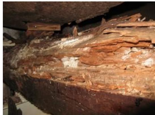
Figura 25. Pudrición blanca. http://blog.simbolocalidad.com/patologias-madera-tratamiento
