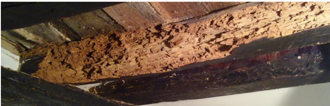
Figura 28. Viga atacada por termitas. http://www.biocea.cl/termitas/
