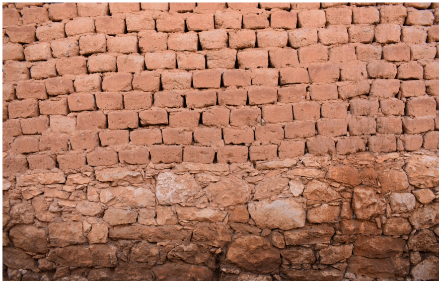
Fábrica de adobe dispuesto a tizón donde su trullado exterior ha sido limpiado por la climatología tras más de 50 años sin mantenimiento. No obstante, la capacidad portante y estructural de muro sigue en funcionamiento a pesar de su situación. Fuente: elaboración propia.
