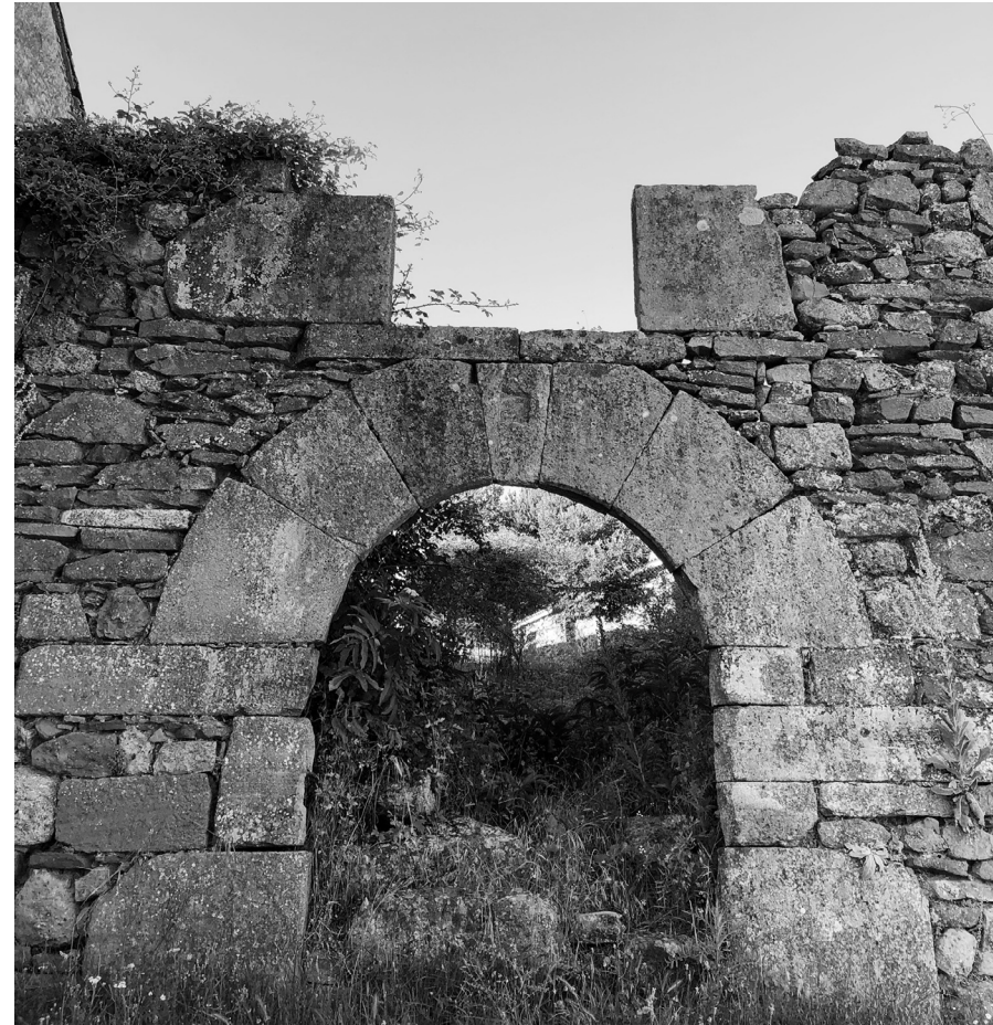
Ni lo que un día fueron magestuosas viviendas señoriales, de alarde arquitectónico y material de la época resisten a la despoblación rural y su abandono arquitectónico
