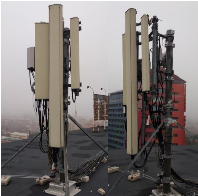
Figura 3.10: Mástil anclado a dado de hormigón
