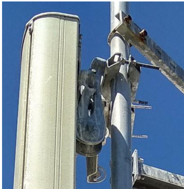
Figura 4.6: Detalle anclaje antenas
