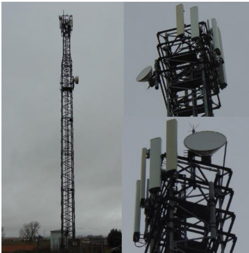
Figura 3.8: Torre de celosía
