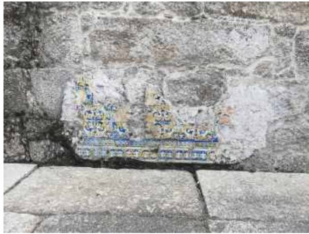
Figura 52: Restos de azulejos en el claustro.
