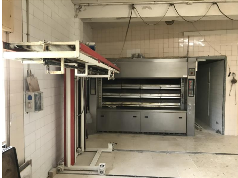
Ilustración 39. Horno principal, a su derecha el hueco para el carro y frente a él la cinta
