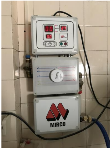
Ilustración 23. Contador de agua (cuenta litros).
