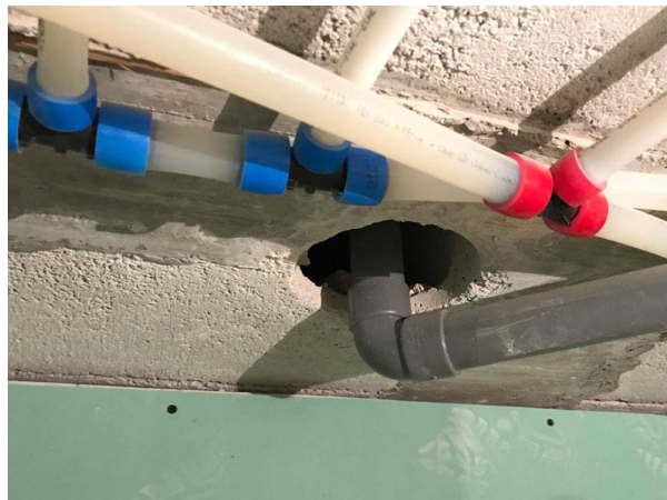
Ilustración 42. Cruce de tuberías de polietileno reticulado. FUENTE: www.zonahogar.es
