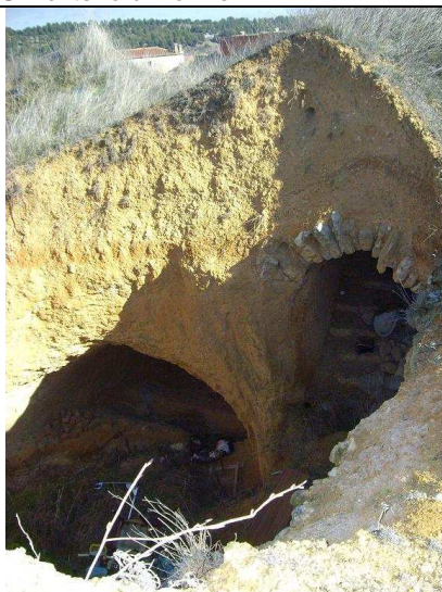
Cubillas de Santa Marta: Derrumbe de una bodega.
