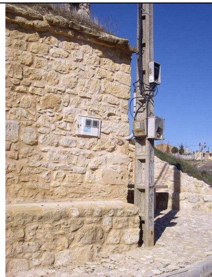
Mucientes: Cableado y contadores en el barrio de bodegas.
