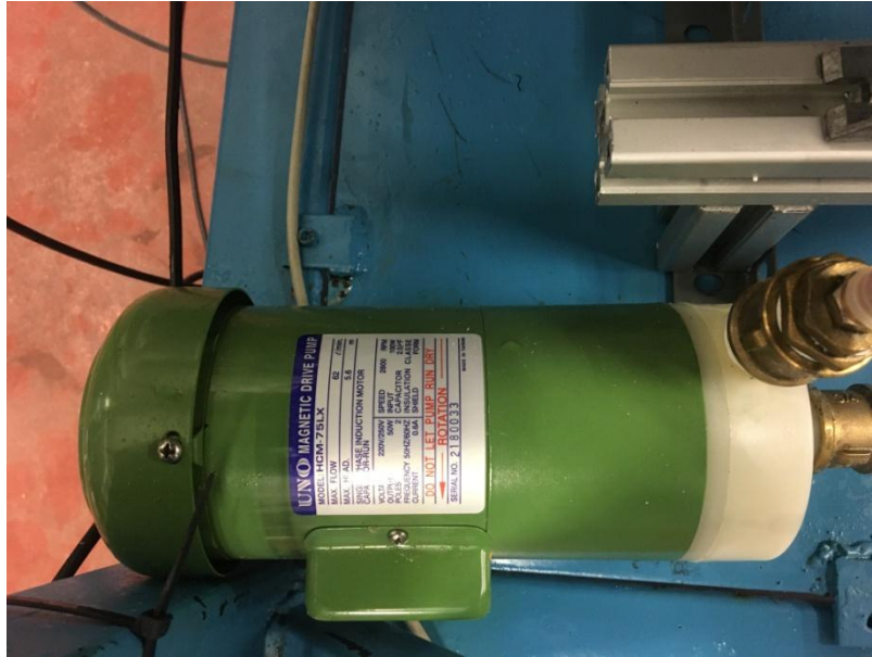
Figura 3.5. Bomba hidráulica de la instalación
