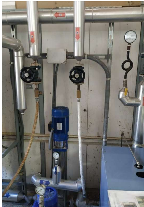
Ilustración 13. Válvulas de control
