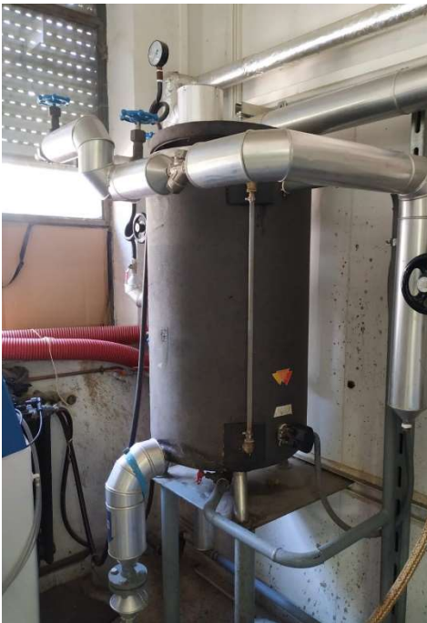
Ilustración 12. caldera de vapor (ETE H-20, España)
