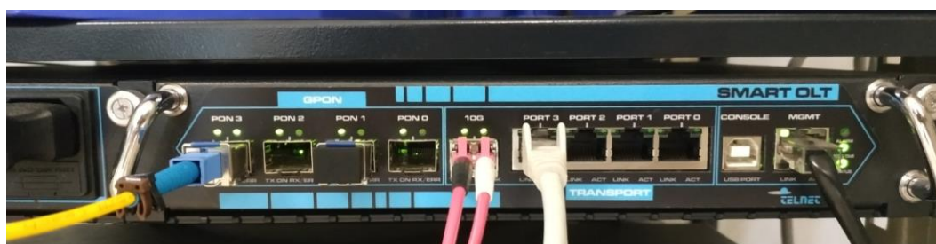
Figura 30: Activación del puert 10G de la OLT
