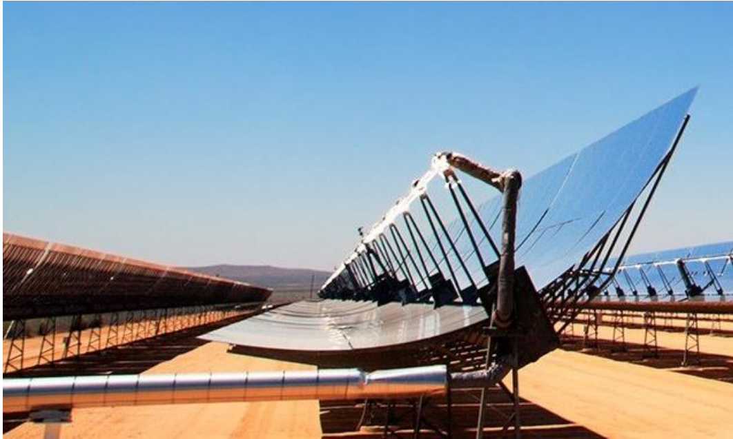
Figura 3.9: Central de colectores parabólicos distribuidos [35].
