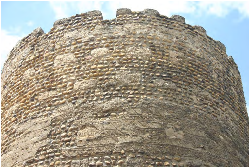
Fig. 17. Fábricas de bolos y damero 3 irregular cubiertas por revocos incisos en los cubos de la muralla de León (A. Gutiérrez).
