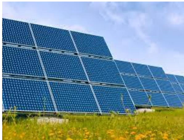
Ilustración 4: Array de módulos solares.
