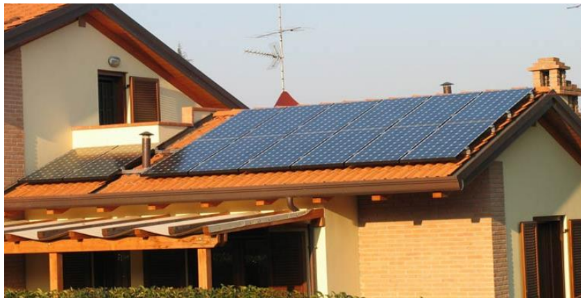
Figura 27. Instalación fotovoltaica en un tejado. Fuente: [14]
