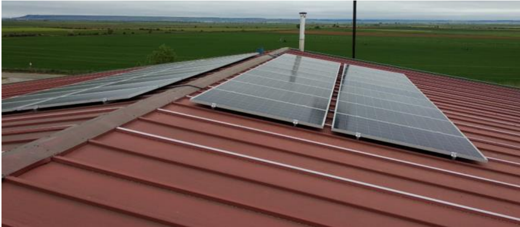
Figura 60. Imagen real de módulos fotovoltaicos en una cubierta. Fuente: [22]
