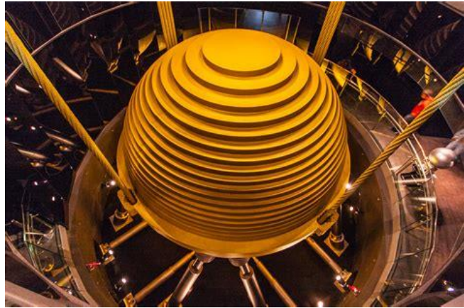
Figura 5. TMD situado en edificio Taipei 101 [23]
